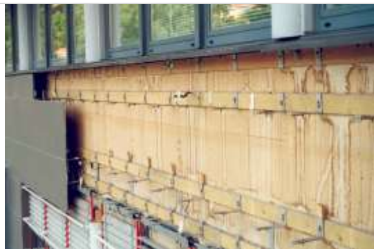
Foto 1. Fasaden i Drammensveien 213 etter at de punktlimte keramiske plater løsnet og falt ned i 2002
